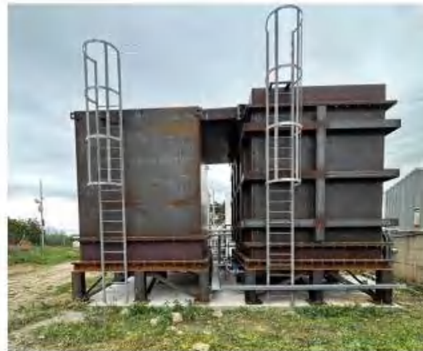
Impianto da 300 abitanti equivalenti presso il depuratore di Ferrandina (MT)
